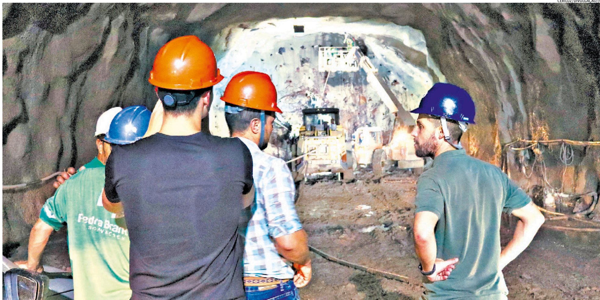
No município de Coronel Barros, a cooperativa Ceriluz finalizou as escavações do túnel que era o maior gargalo da sua nova usina, a Pequena Central Hidrelétrica (PCH) Linha Onze
