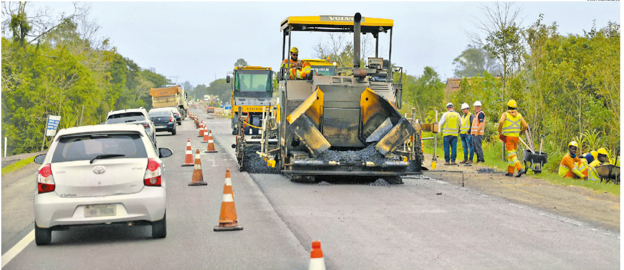
Obras na rodovia RSC-287, concedida para o grupo espanhol Sacyr; projeção é que 130 quilômetros da estrada sejam duplicados até 2026, com investimentos de R$ 1,5 bilhão
