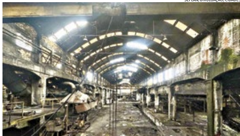
Reforma ocorrerá após avaliação sobre risco de colapso da estrutura existente
