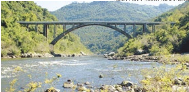
Travessia permanece totalmente interditada por conta de problemas na estrutura
