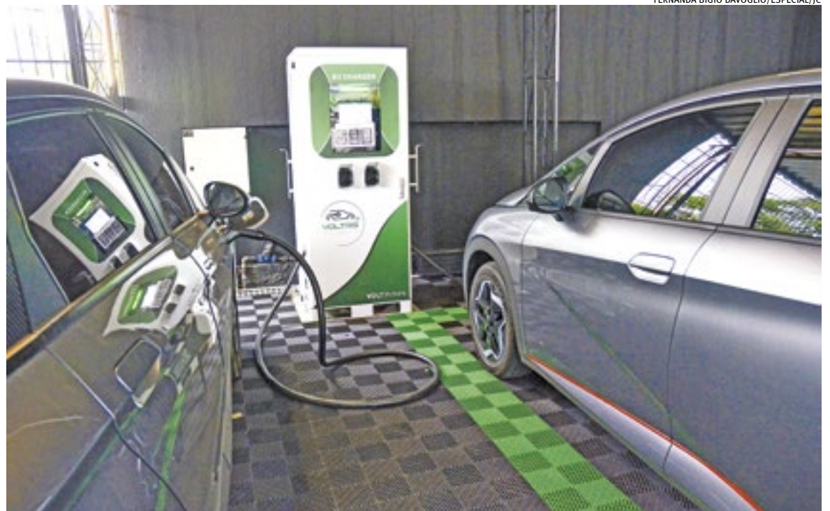
Na VoltRS, localizada na avenida Ipiranga, são carregados em média 40 automóveis por dia
