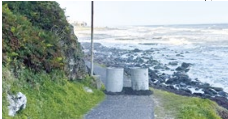
Chamado de Caminho da Santinha, ligação tem risco de deslocamento de pedras
