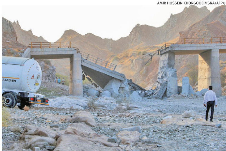
Ataques dos EUA causaram danos estruturais nas proximidades de Ormuz
