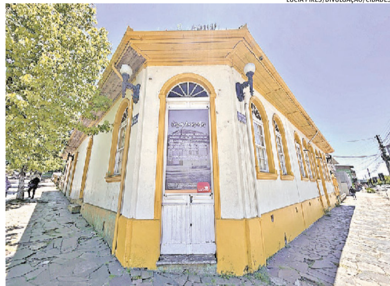
Com quase um século de existência, Casa Amarela vai passar por restauração
