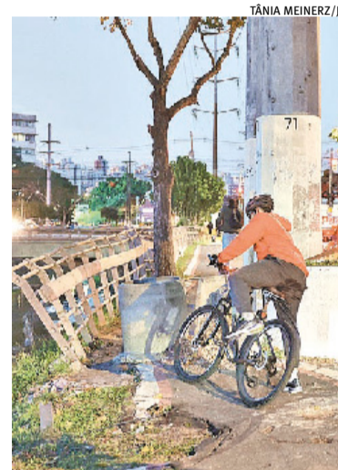
Principal passagem para ciclistas de Porto Alegre continua destruída
