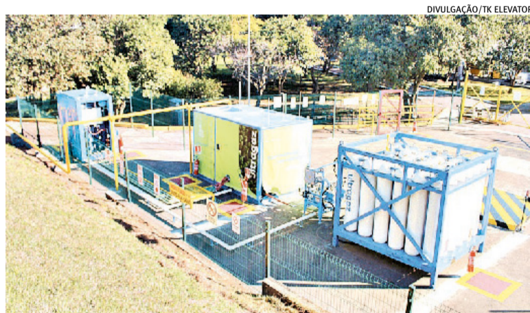
Nova central de gás com combustível renovável entra em operação hoje
