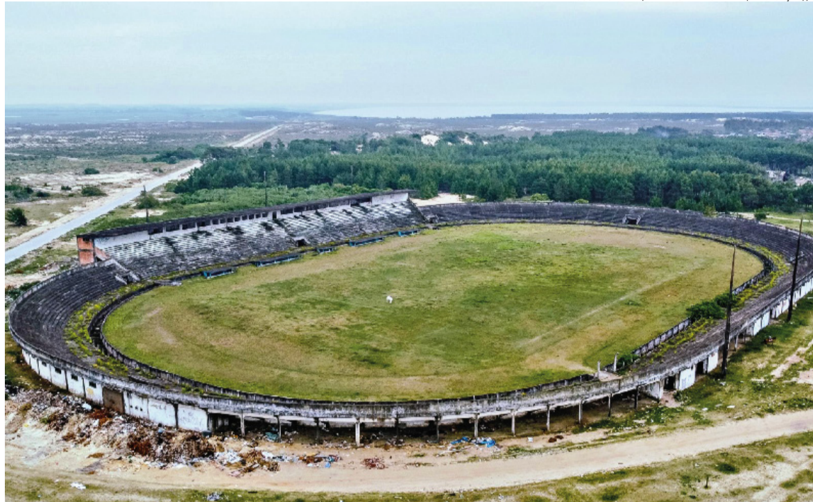
O estádio está interditado desde 2010 a pedido do MPRS, até que sejam realizadas as obras de recuperação necessárias
