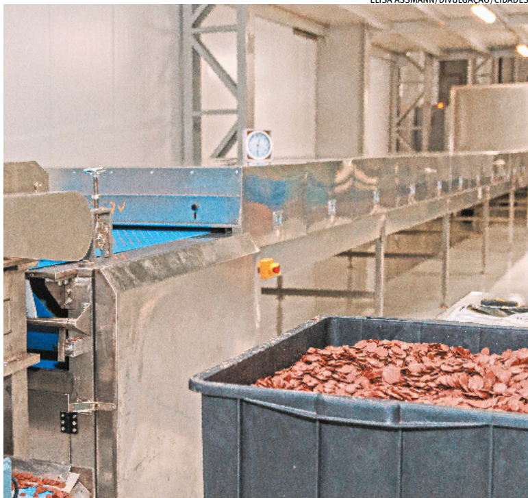
Sede da Tradição Gourmet Chocolates foi destruída por incêndio há dois anos
