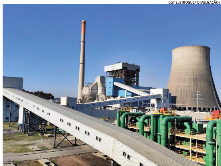
Usina termelétrica a carvão tem capacidade instalada de 350 MW
