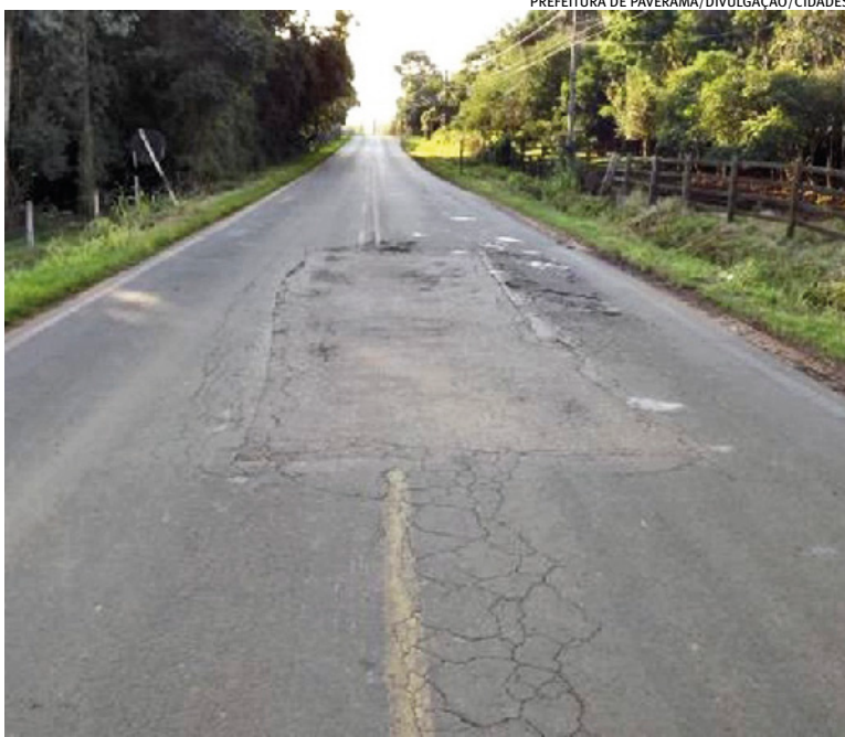
Buracos, afundamentos de pista e valetas foram identificadas em avaliação do trecho
