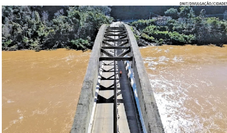
Estrutura, que tem mais de 70 anos, apresenta sinais de desgaste
