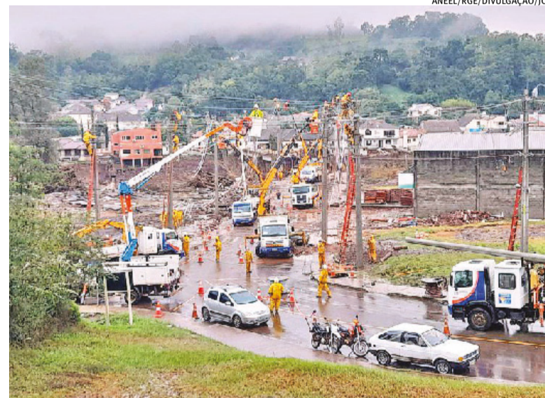
Medida busca reduzir impactos na rede elétrica causados por ventos intensos
