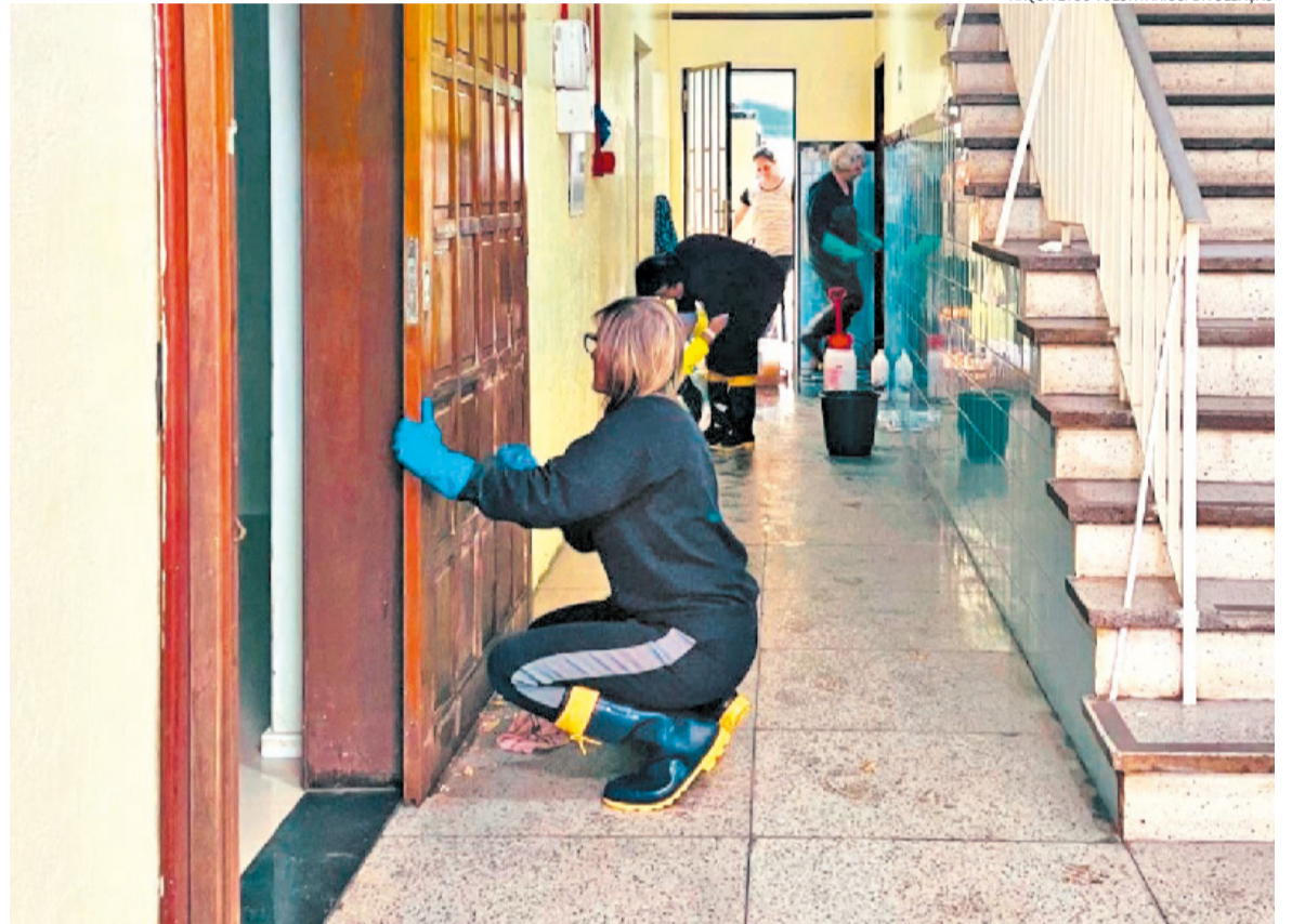
Serviços de reparos ocorrem em diversos locais, como no Centro de Educação São Vicente de Paulo, na Capital
