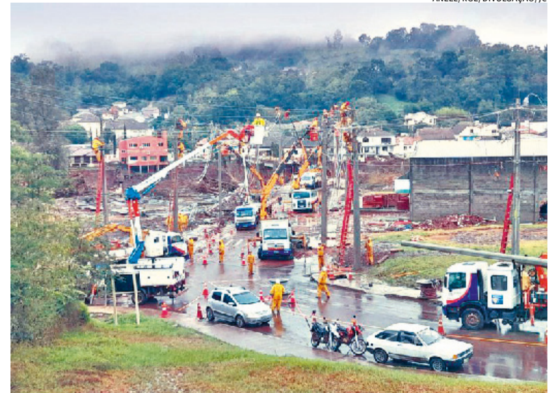
Decisão foi tomada devido aos danos provocados pelas chuvas no Estado
