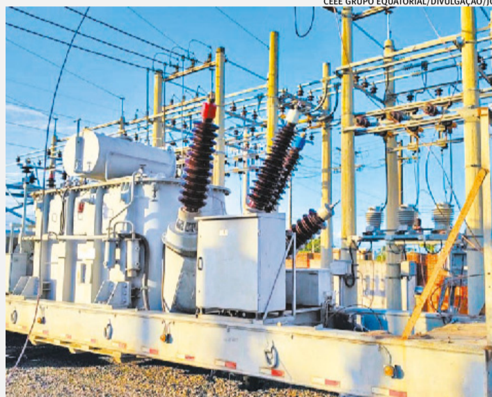
CEEE Equatorial investiu em três novas subestações de energia no Estado
