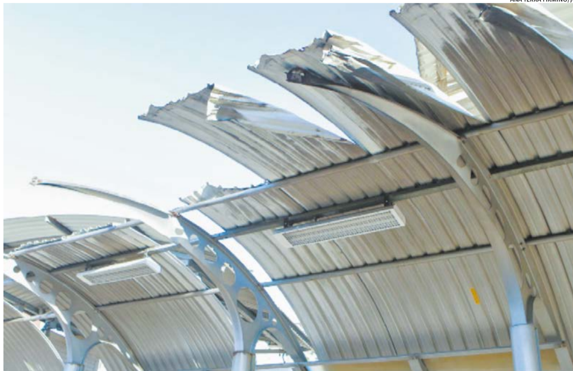
Terminal Mendes Ribeiro, na Zona Leste da Capital, tem parte da cobertura comprometida
